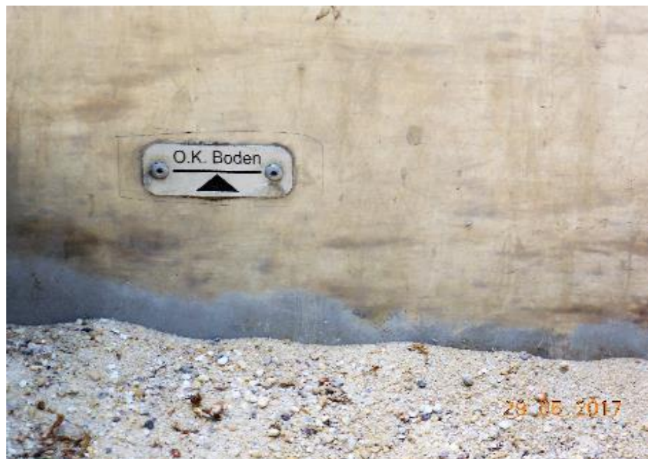
zu geringe Fallschutzauflage an Rutsche
